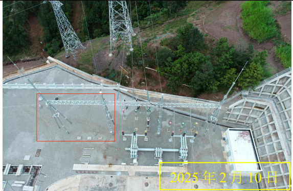
终点备用进线间隔
