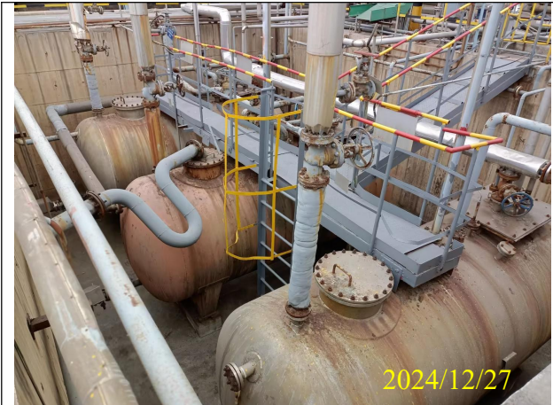
库区依托的事故废水储槽
