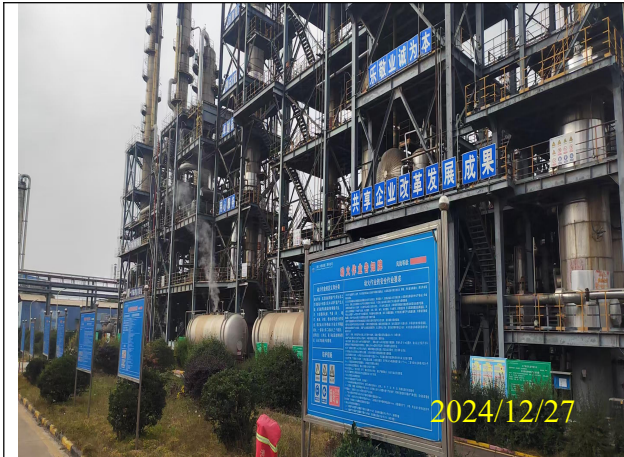
苯加氢精制装置区
