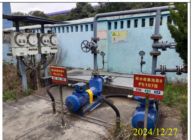
装置区初期雨水收集池
