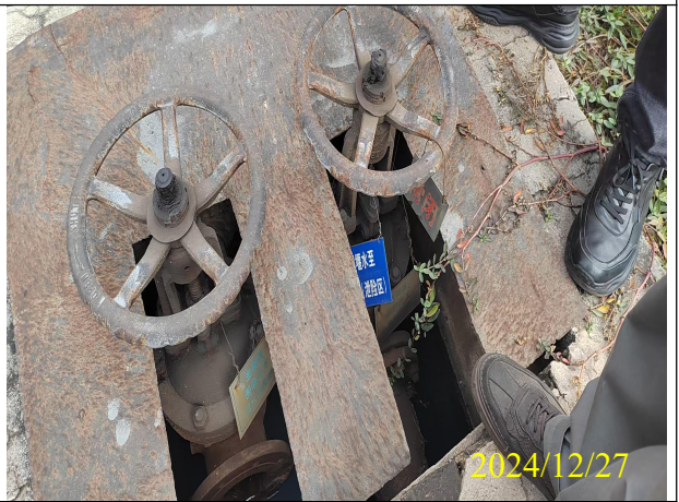
初期雨水收集池切换闸门
