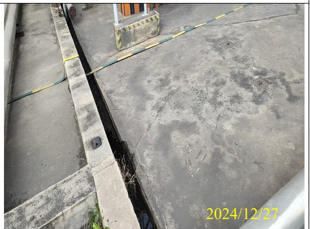
装置区排水沟
