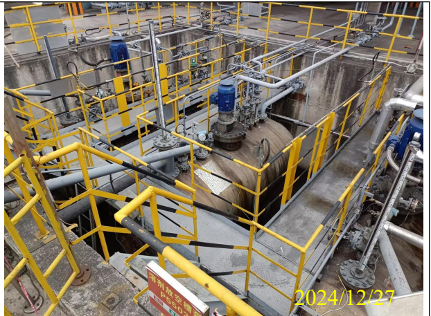
装置区依托的事故废水储槽
