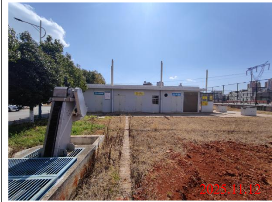
医院污水处理站
