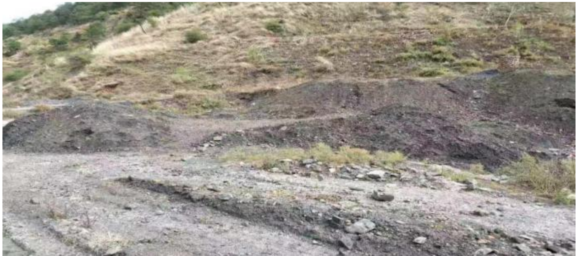
不稳定边坡 BW1
