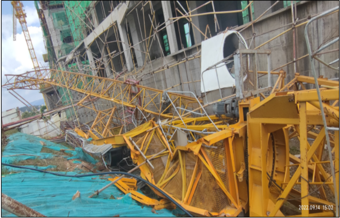
图 2 事故现场地面图
