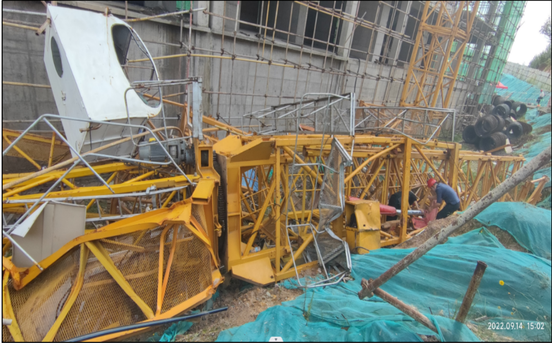
图 3 事故现场地面图
