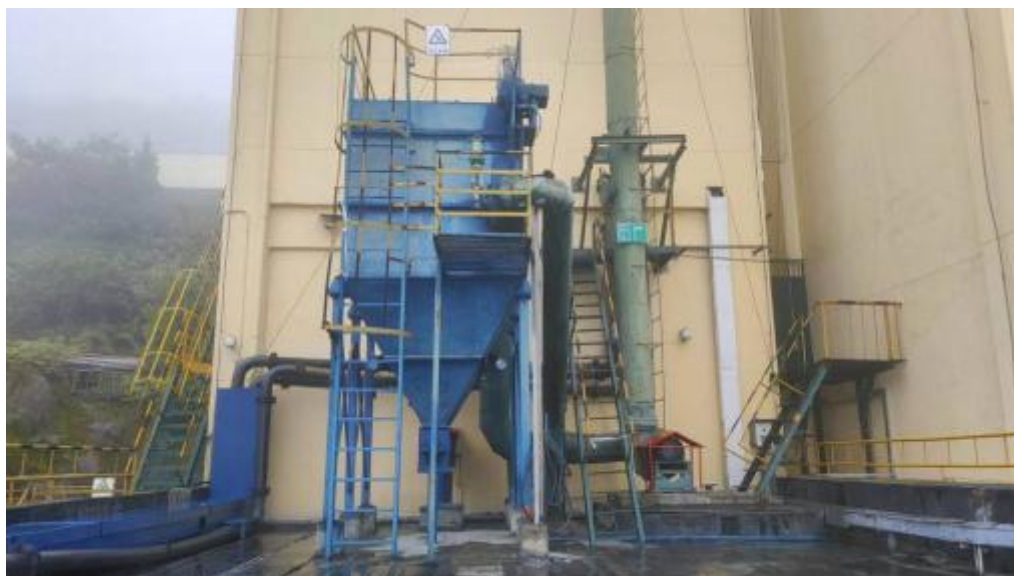
除尘设备照片
