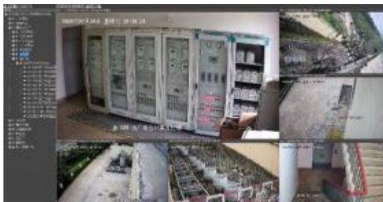
矿区供电系统 照片
