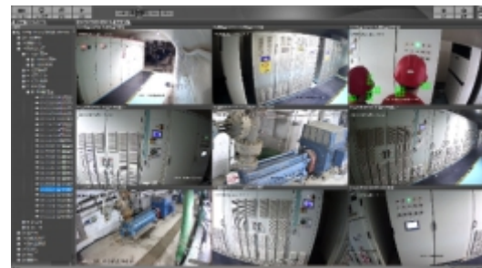
矿区供排水系统照片
