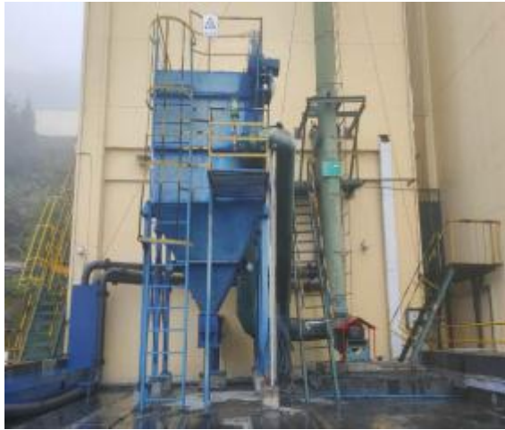
破碎风机除尘装置 照片
