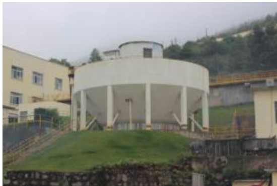
选矿厂工业废水处理系统 新二级沉降池照片
