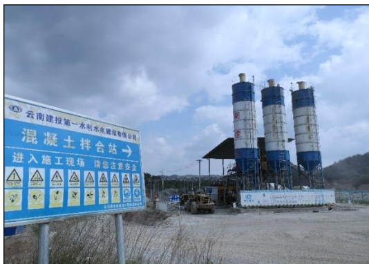
混凝土拌合站
