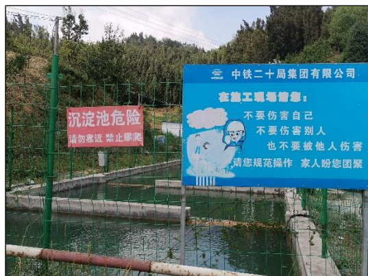
沉淀池警示牌
