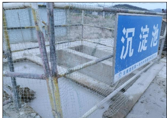
混凝土拌合废水沉淀池
