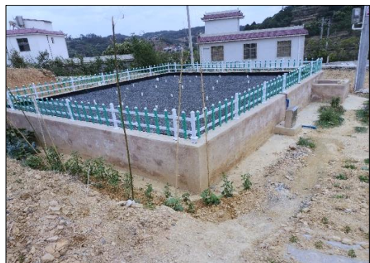
移民安置点生活污水处理设施
