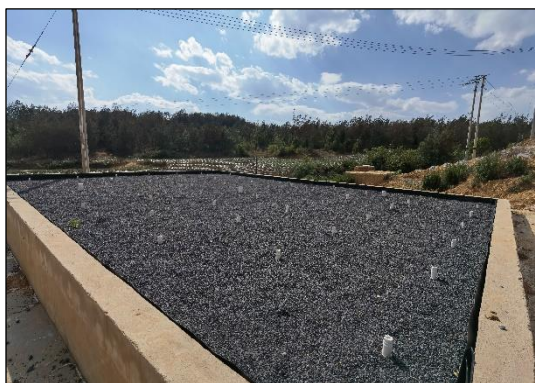
白塔村污水处理设施
