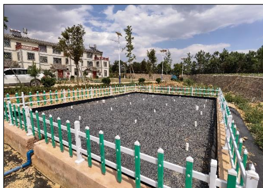
罗贵新村污水处理设施
